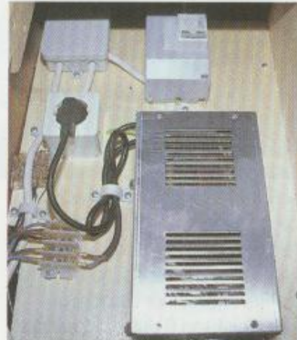
Ladegerät und Sicherungsautomat.
