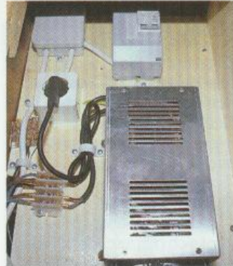
Ladegerät und Sicherungsautomat.
